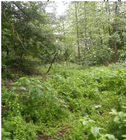
Fot. 4 Zaniedbany rów melioracyjny przy ul. Malinowej
